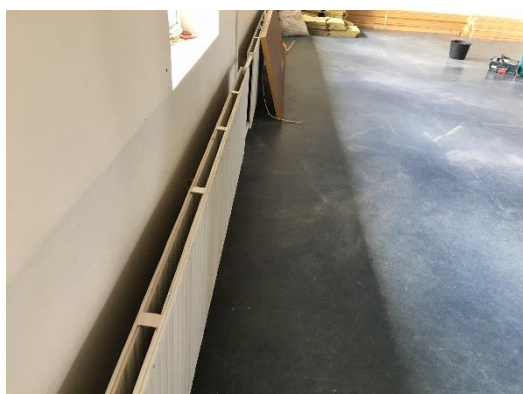
Foto af radiatorer langs vægge
