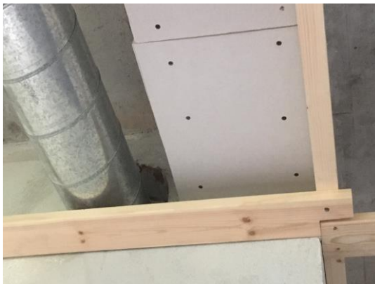
Ventilationskanal gennem væg
